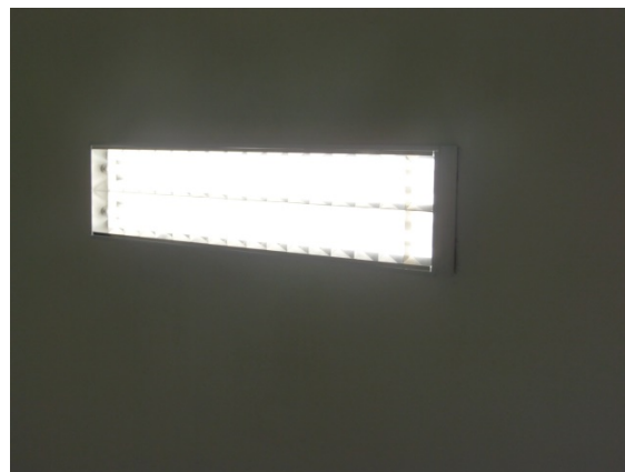
Figura 8.7 - Particolare impianto illuminazione su cui intervenire.
