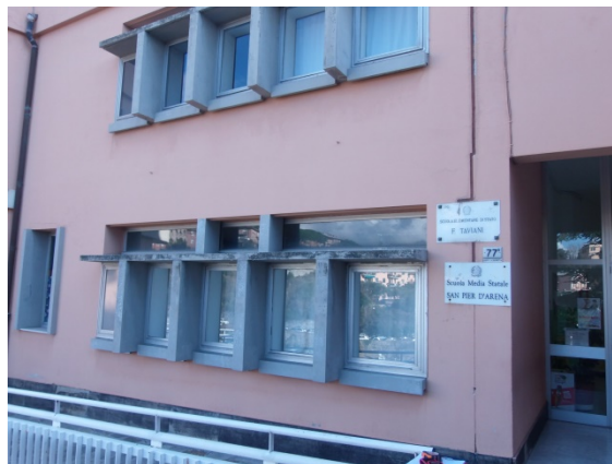
Figura 8.1 - Particolare serramenti da sostituire.
