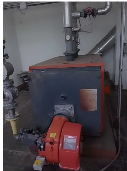
Figura 8.5 – Particolare sistema di generazione obsoleto da sostituire
