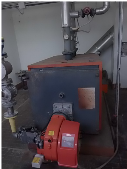
Figura 4.9 - Generatore di calore – UNICAL P500
